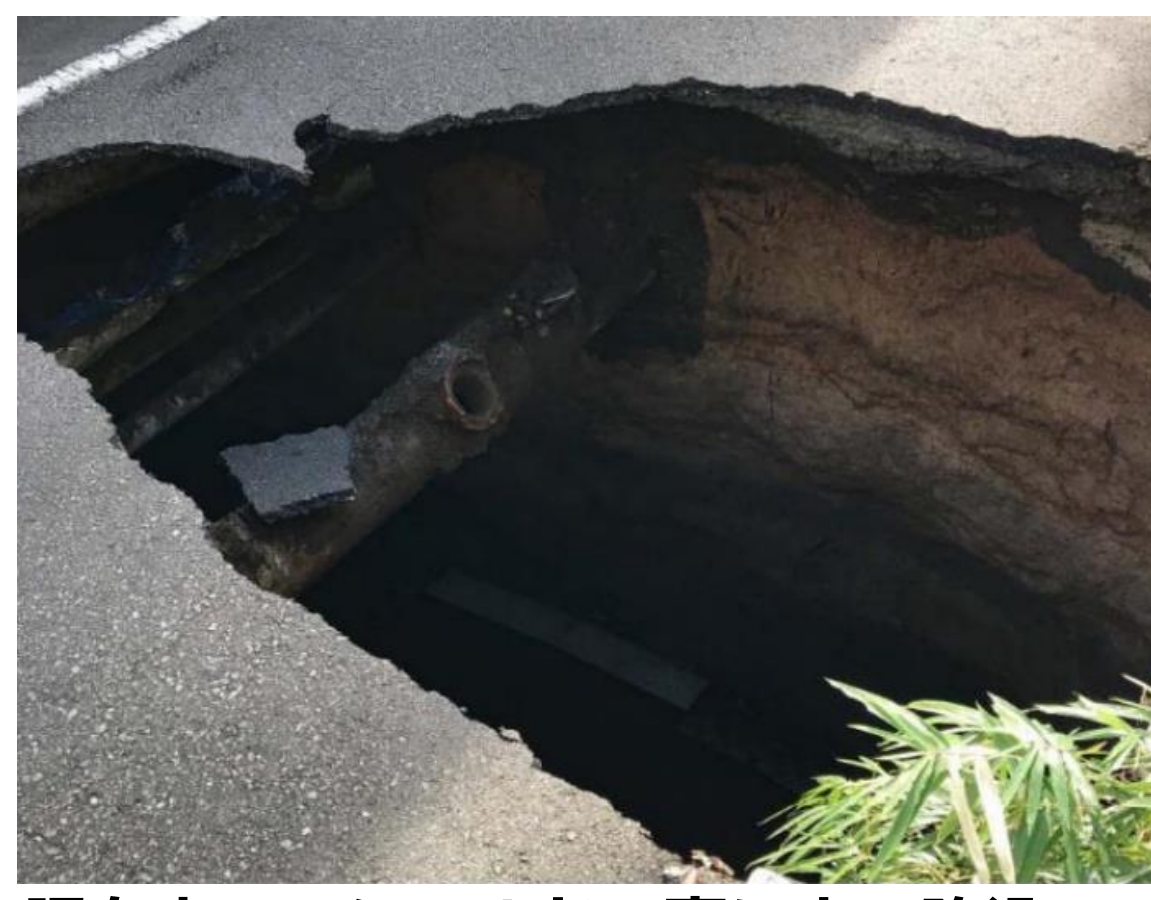
調布市でのシールド工事による陥没[2]
